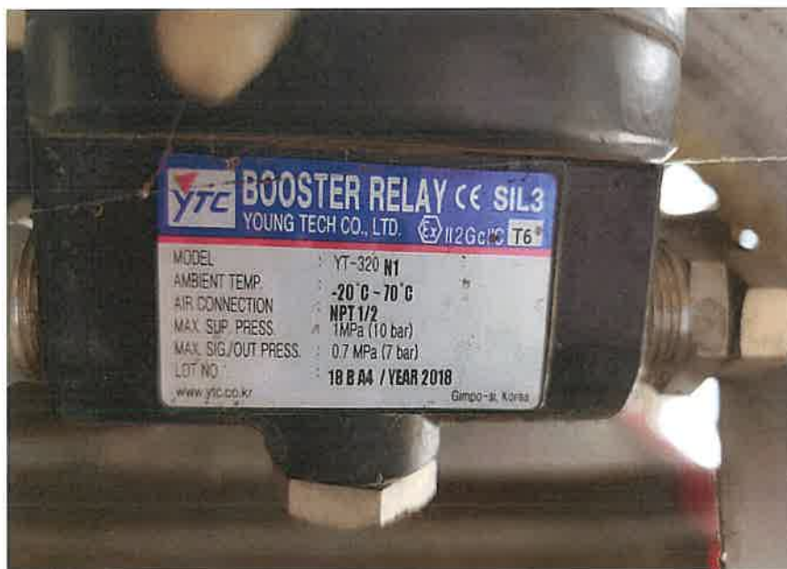
Hình 2- bộ booster van đầu thoát quạt gió chèn máy nghiền
